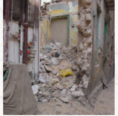
مخلفات مبنى متهدم
