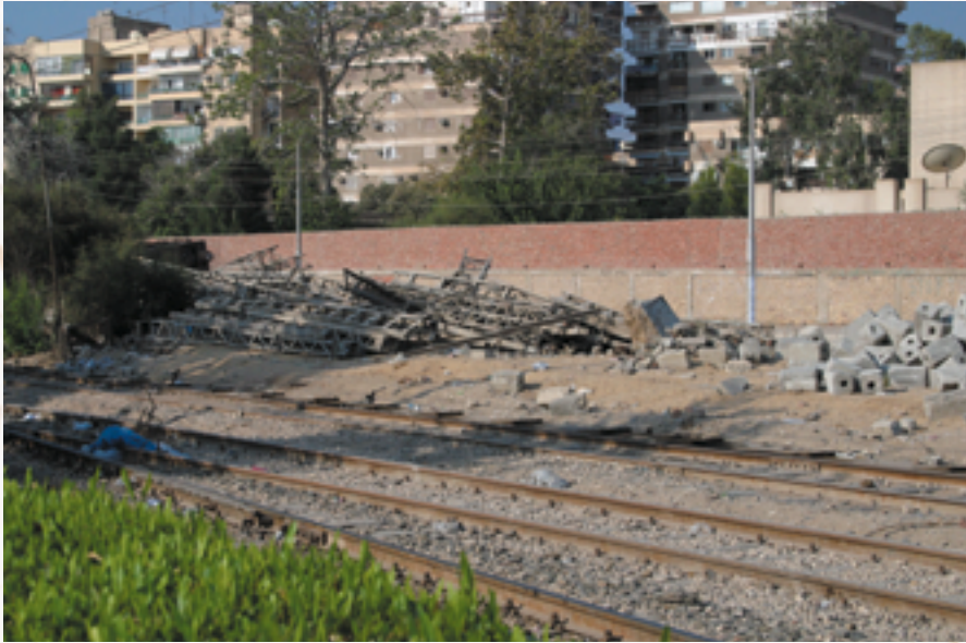
حطام بناء طريق سكة حديد.
