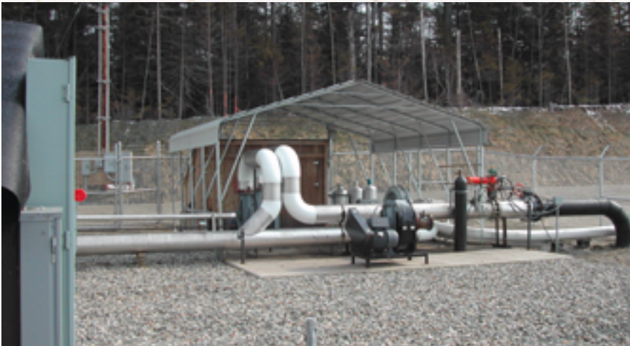
منطقة تجميع غاز المدفن
